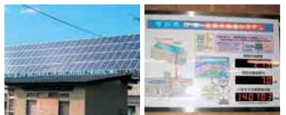
太陽光発電システム
